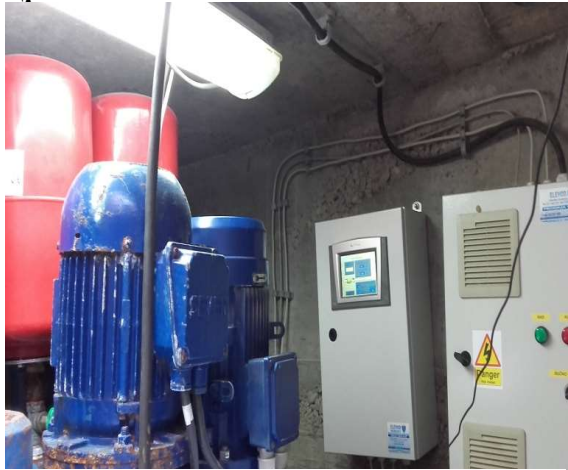
Слика 8: Унутрашњост ЦС Шид-2
