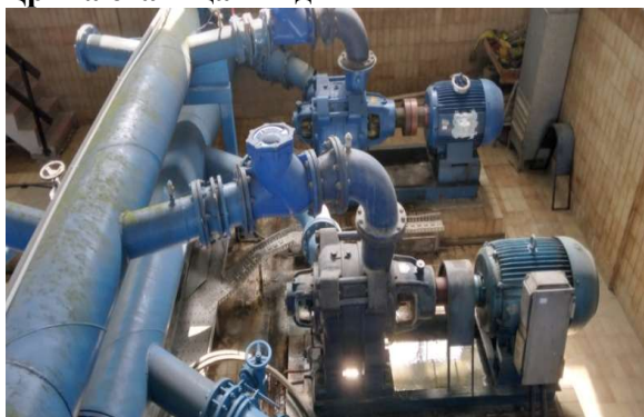
Слика 5: Пумпе на црпној станици Шид
